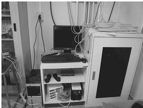
図1 サーバおよびネットワークボックス
