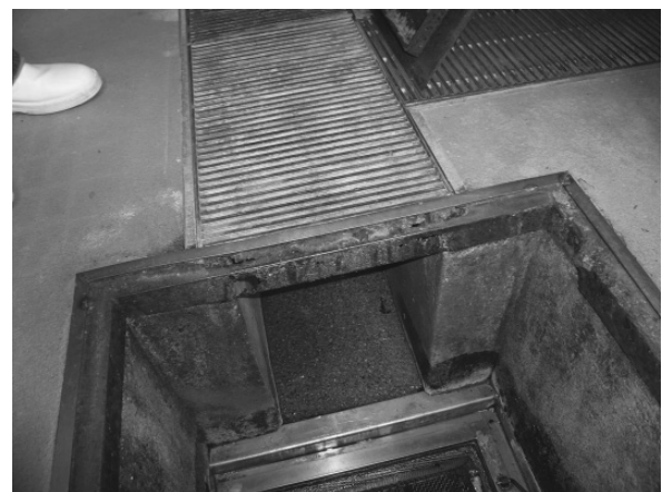
写真4：錆びた排水の油分分離のためのグリストラップのふた内側。調理場全体の排水溝グレーチングも錆び・ゆがみがあり、作業者は「いつも気になっていた」。
