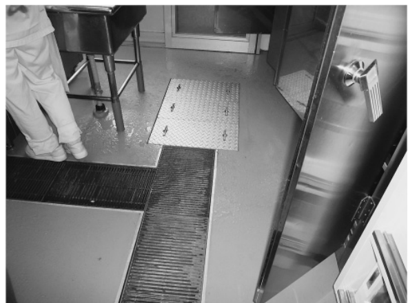
写真7：新しくなったグレーチング。
